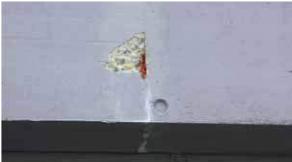
Éclatement en raison d'un recouvrement insuffisant
