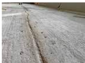
Fissures dans la plaque de fond
